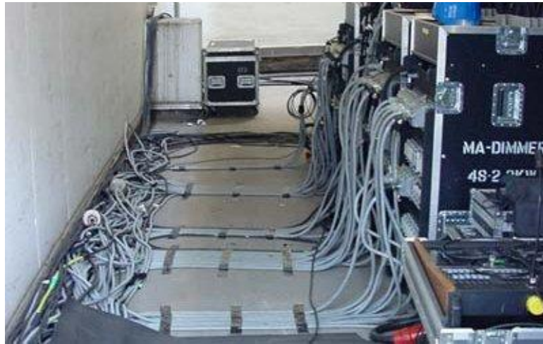
Resim 3.9: Dimmerler ve dimmer odası
