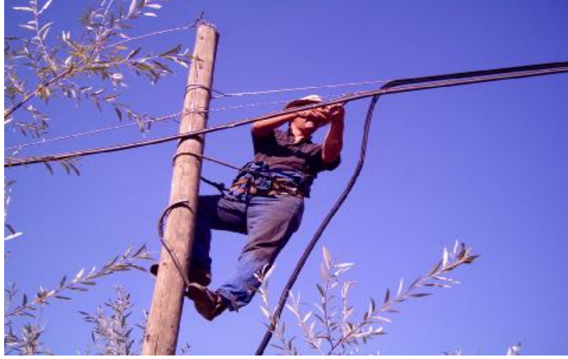
Resim 3.1: Arızalı kablo deęiřimi
