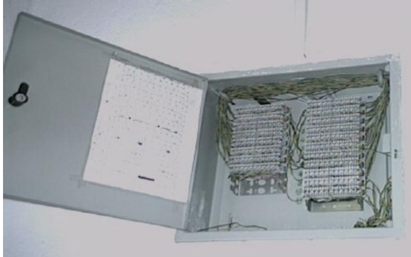
Resim 4.17: Bina ana giriş terminal kutusu iç yapısı
