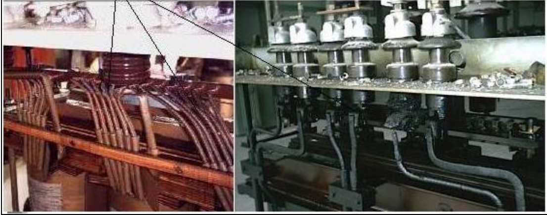
Resim 1.10: Yanmış trafo sargıları
