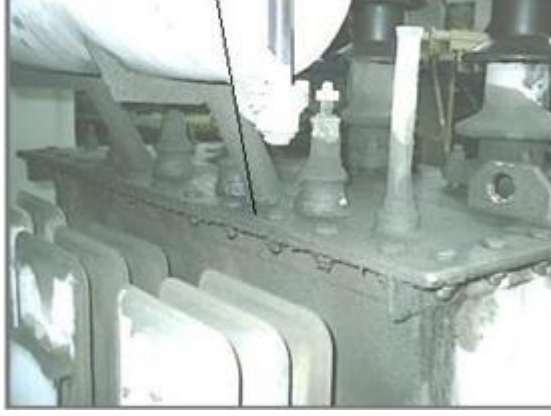
Resim 1.9: Kazan dışına taşmış trafo yağı
