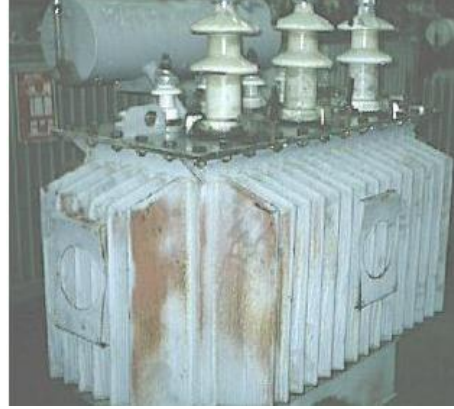
Resim 1.14: Boyası deforme olmuş transformatör
