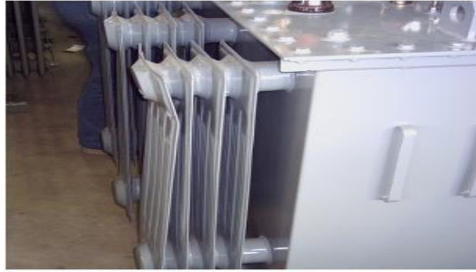
Resim 1.12: Nakliye esnasında hasar görmüş trafo
