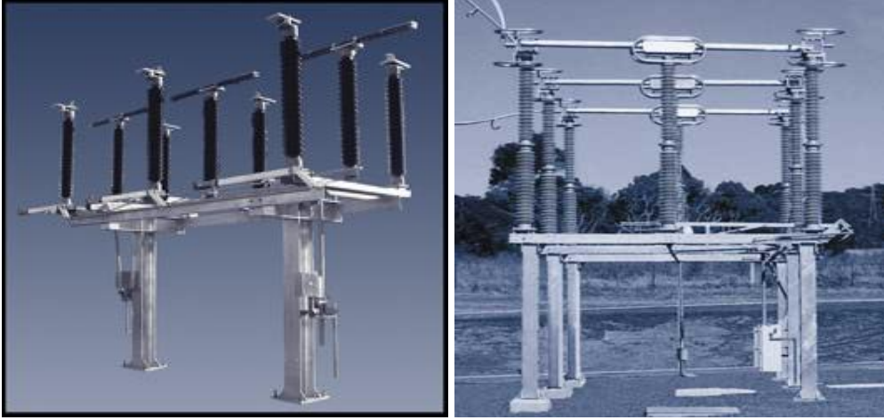
Resim 1.7: Tek döner izolatörlü (döner izolatörü ortada) ayırıcılar
