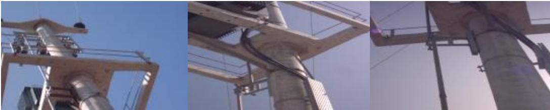
Resim 2.4: Ayırıcı kumanda mekanizma kolu
