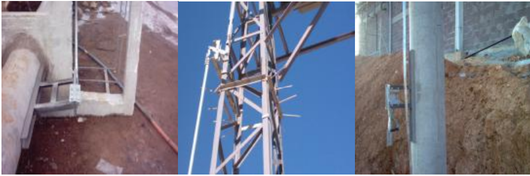
Resim 2.3: Ayırıcı kumanda mekanizma kolu
