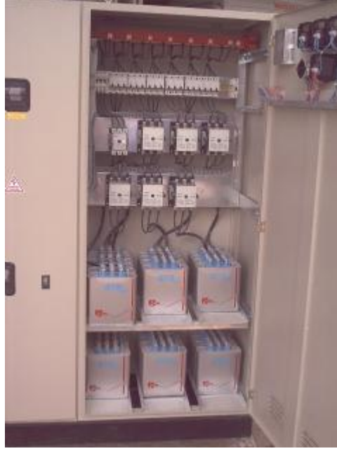
Resim 1.7: Orta büyüklükteki bir sanayi işletmesinde bulunan kompanzasyon panosu
